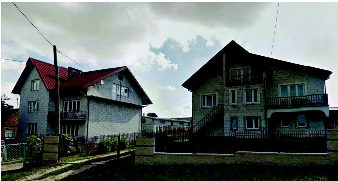
Fot. Niedocieplone domy w miejscowości Gródek Rządowy
